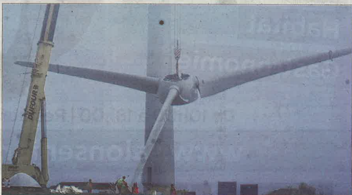
Les pâles des éoliennes sont levées et fixées à la nacelle. Ensuite, deux techniciens feront les raccordements. Ingrid Julien
